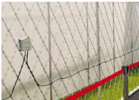
Zdj. 1. Przykład detektorów przewodowych instalowanych na ogrodzeniu Źródło: materiały własne.
