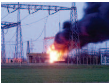
Zdj. 1. Pożar transformatora wysokiego napięcia w stacji GPZ
