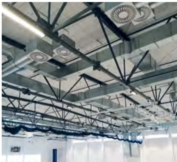
Rys. 1. Wnętrze hali sportowej w Gdańsku – cała powierzchnia sufitu zastąpiona jest panelami akustycznymi
